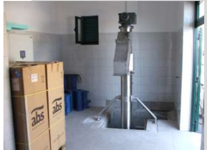
Slika 7.: Ugrađeno fino spiralno sito Q= 70 l/s
