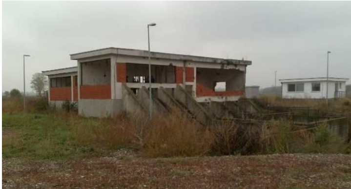
Slika 3.: Postojeći objekt – Ulazna crpna stanica za otpadnu i crpna stanica za oborinsku vodu s autmatskim mehničkim rešetkama
