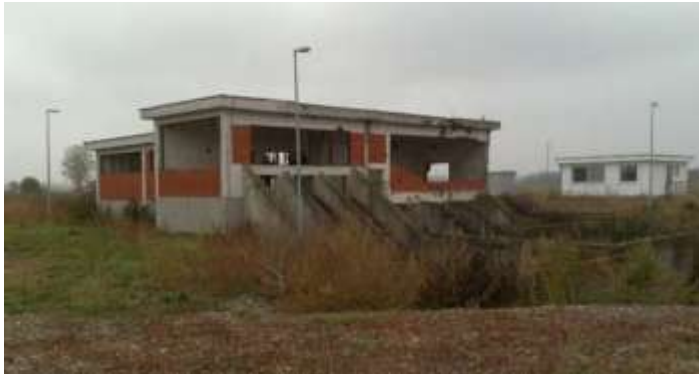
Slika 3.: Postojeći objekt – Ulazna crpna stanica za otpadnu i crpna stanica za oborinsku vodu s autmatskim mehničkim rešetkama
