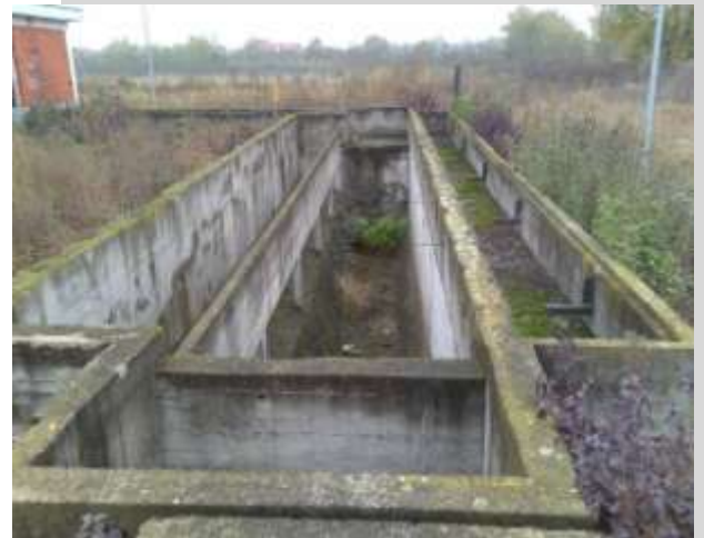
Slika 4.: Postojeći objekt – Aerirani pjeskolov- mastolov
