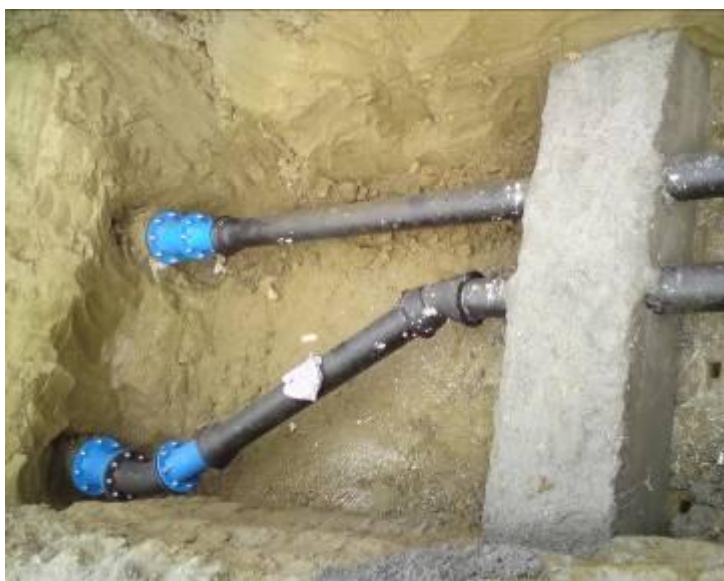
Slika 2.: Spojni cjevovod od spojnog okna do PS od duktilnih cijevi DN150, PN10
