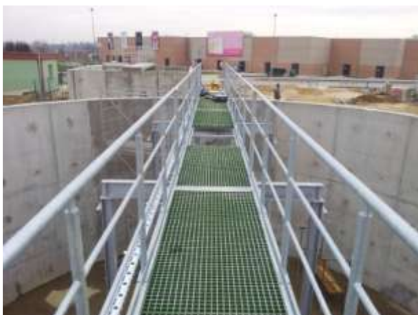
Slika 7.: Pogled na servisni most bioeracijskog bazena
